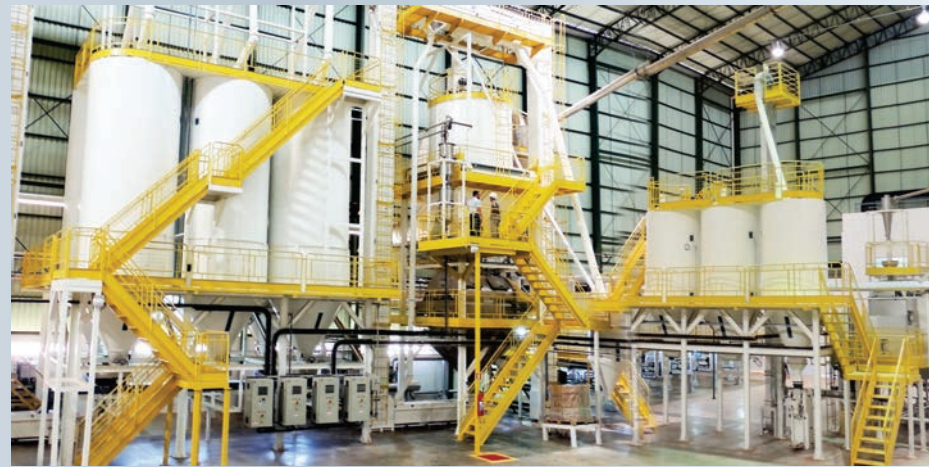
Resfriamento / Cooling / Enfriamiento Aplicação de Gordura e Palatabilizantes / Liquid Coating for fats and flavors / Aplicación de grasa y aroma Secagem / Drying / Secado
